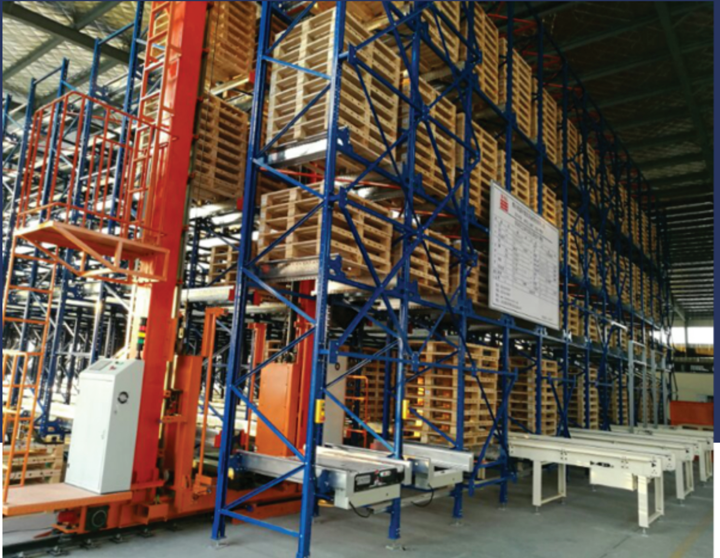
TRANSELEVADOR DE DOBLE COLUMNA + SHUTTLE, ALMACÉN AUTOMATIZADO.
