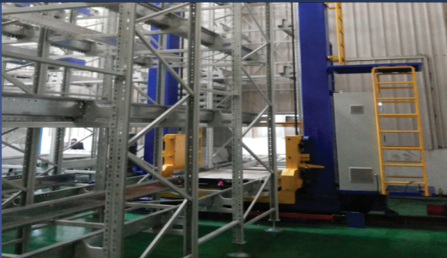
TRANSELEVADOR DE DOBLE COLUMNA + SHUTTLE, ALMACÉN AUTOMATIZADO.
