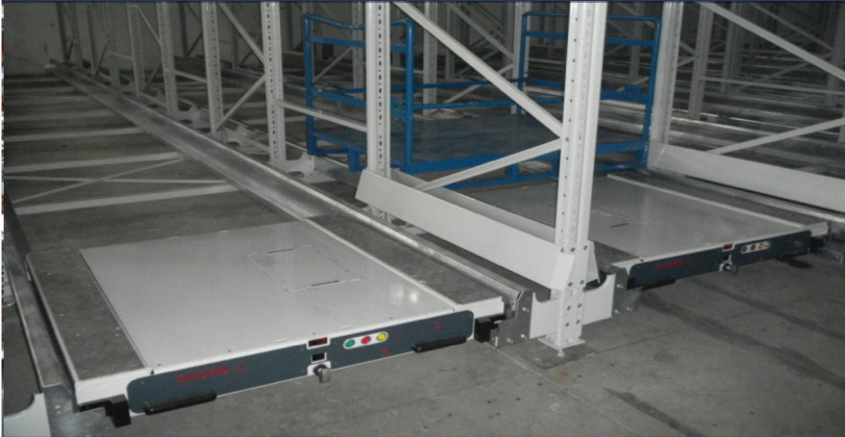
SHUTTLES DE BAJA TEMPERATURA + MONTACARGAS, ALMACÉN SEMIAUTOMÁTICO
